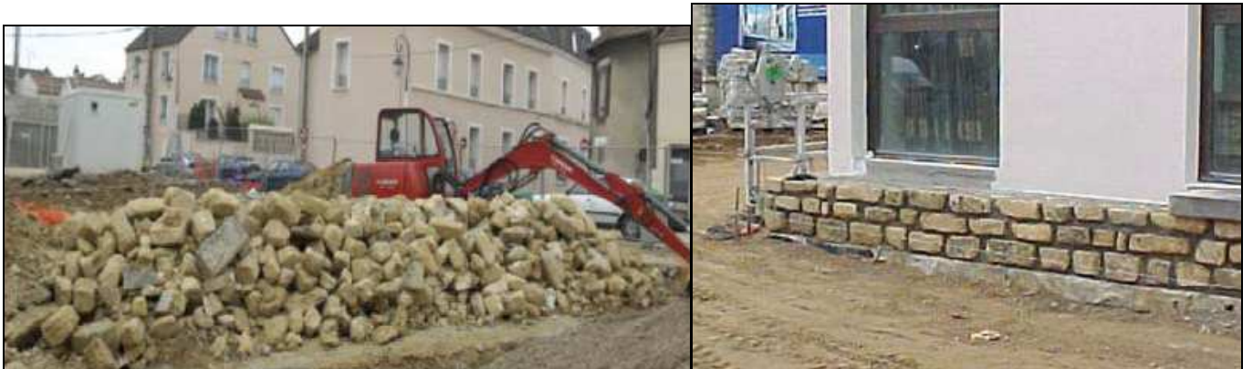
Illustration 83 : Chantier de la mairie des Mureaux, tri des pierres lors de la démolition et réutilisation en soubassement.
